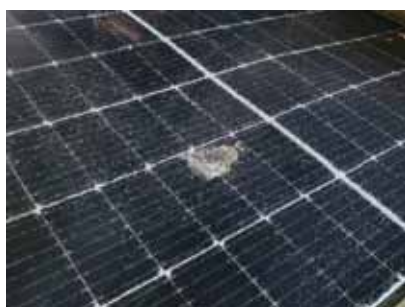
Rys. 1. Przykład uszkodzonego panelu fotowoltaicznego
